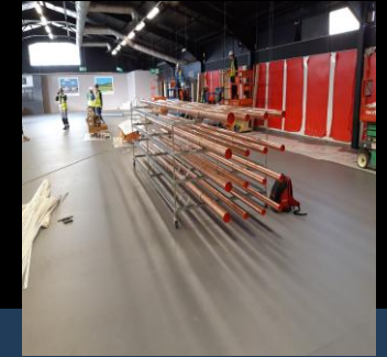
Med Gas Modules
